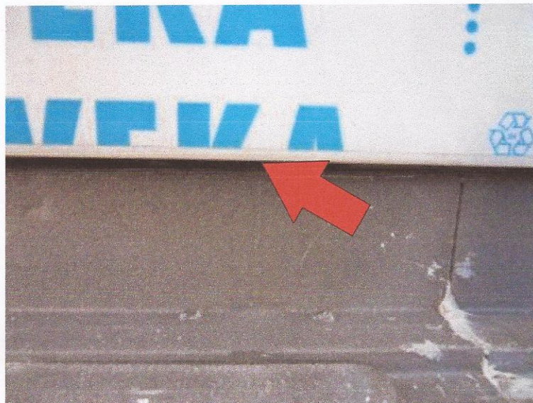
zaobserwowane miejsce przecieku wody
